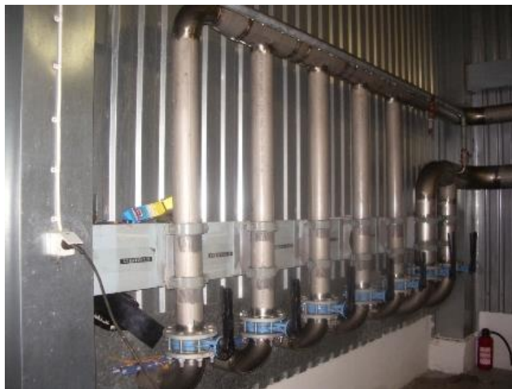
Рис. 3. Вид системы подачи воды из скважин в помещении ВОС
