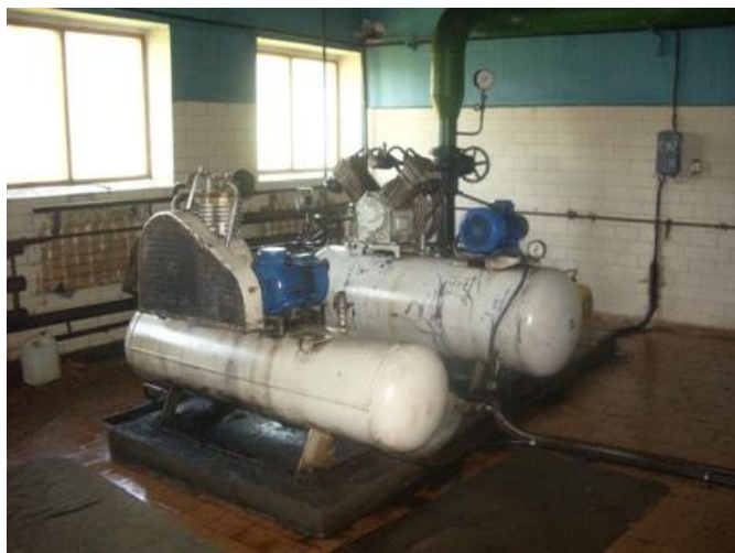
Рис. 11. Компрессорная станция для нагнетания воздуха
